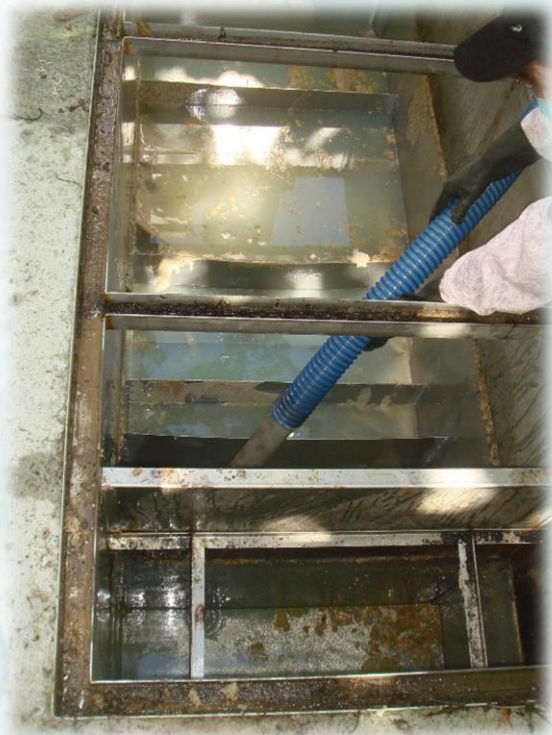
油脂截留器抽油脂
