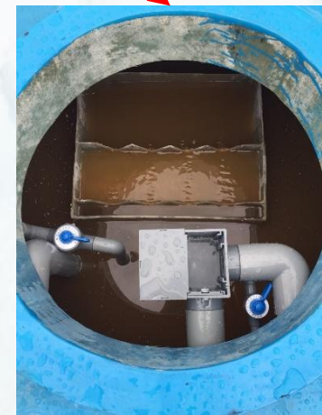
沉澱槽 及 消毒放流槽
