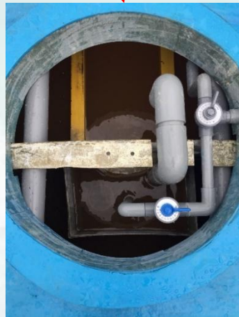
無氧濾床槽一 及 無氧濾床槽二
