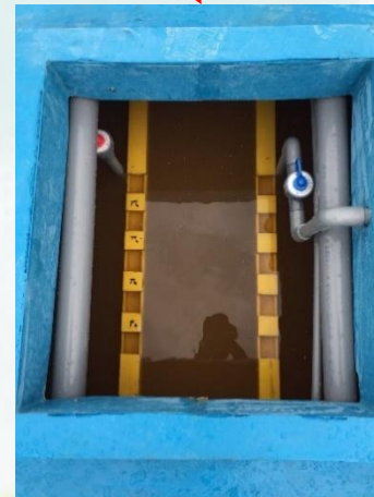
好氧濾床槽 (電解板裝置)
